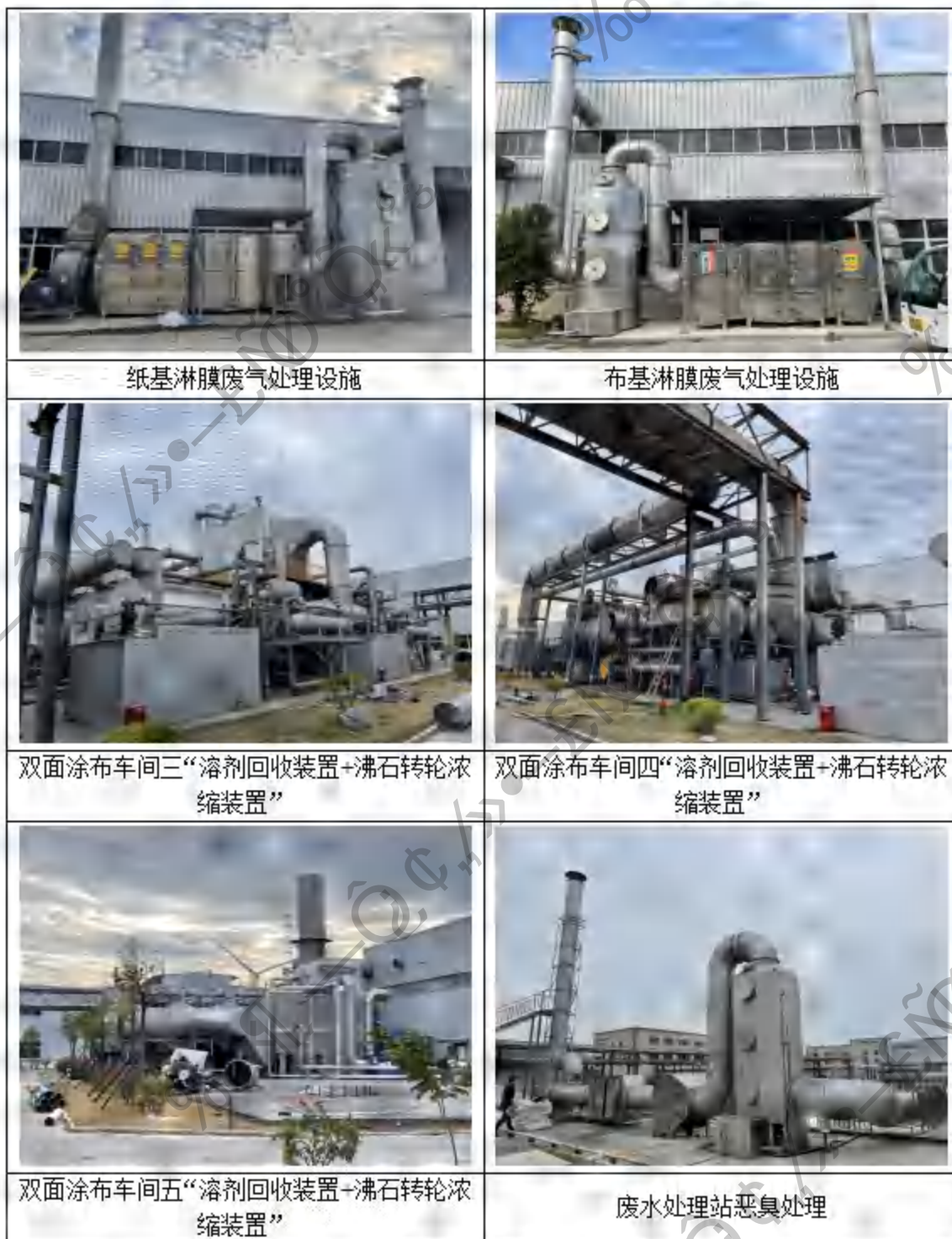
图 4.1-4 有组织废气治理设施
